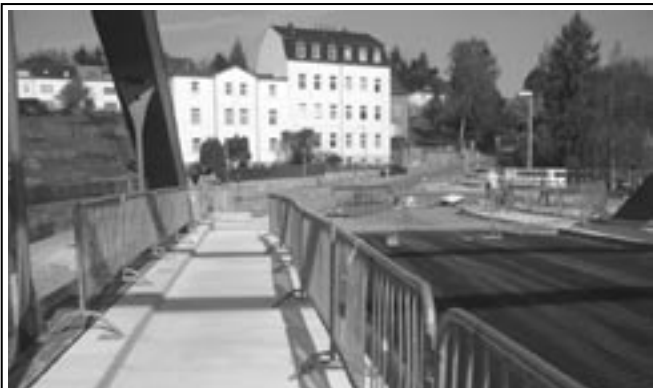
Die Bauarbeiten an der Bahnbrücke in Gößnitz neigen sich dem Ende entgegen. Für den 28. Juni ist die Einweihung der Brücke vorgesehen.
